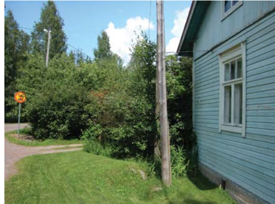
Tontin 0005-0015 sisäänkäynti I-linjalta piiloutuu kasvillisuuden sisään. I-linja on noussut liian korkealle kuten betonikivijalan tuuletusluukusta näkee. Linjalla rakennuksen edessä on kapea omenapuutarha. Rakennuksen päädyssä on linjalle ikkuna ja rakennuksen edessä on nurmialue.
