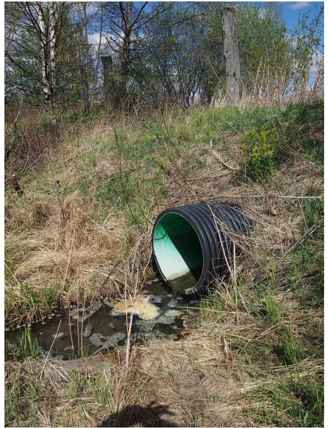
Prisman asfaltoidun pysäköintialueen sadevesien purkuputki Loimijokeen.
